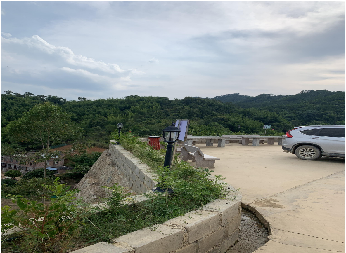
办公区排水设施
